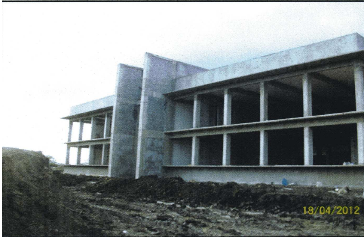
INSTITUTO TECNOLOGICO DE CD. VALLES (EDIFICIO MULTIFUNCIONAL) CD. VALLES, S.L.P.
